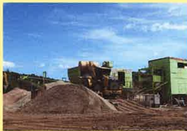
4230 ジョークラッシャーへの 300 アンダーガラ投入
