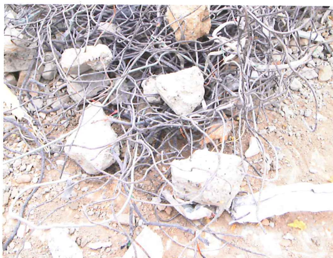
(スラブ内から回収した細かい鉄筋の状況)
